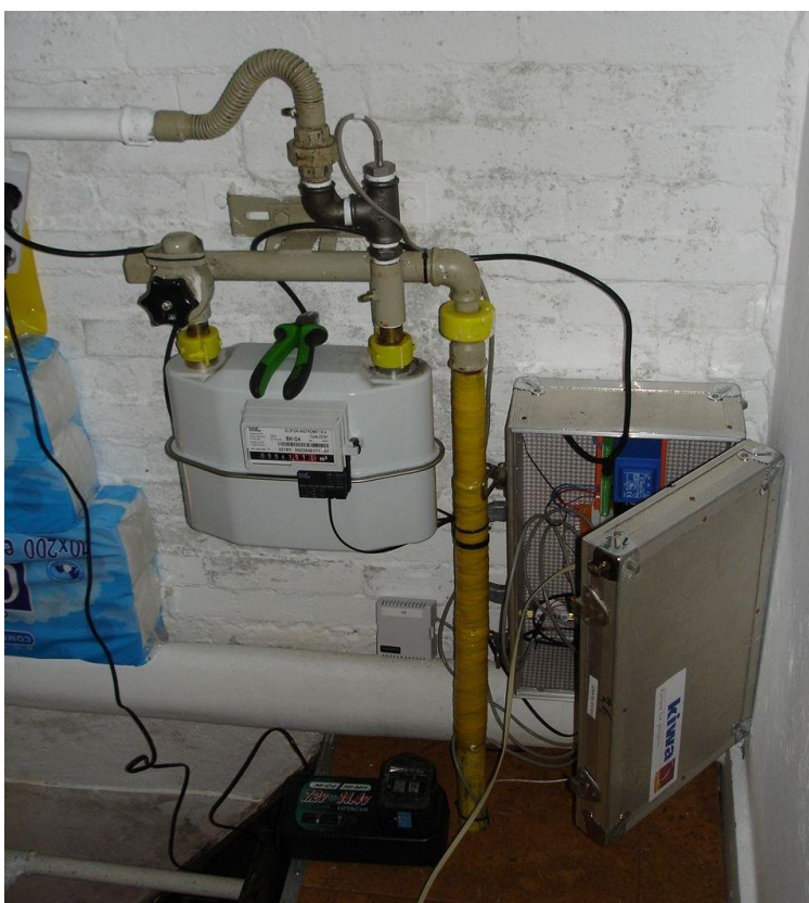
Figuur 2: Voorbeeld van een geïnstalleerde meetset in een kelder
