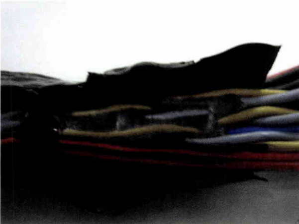
Figuur 3.4-4 Verbinding van een kabelverlenging
