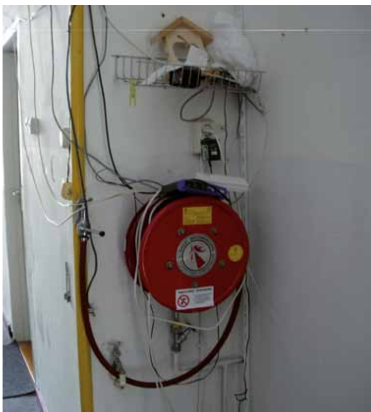
Wirwar elektrische installatie
