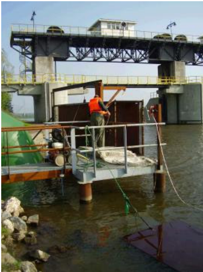
Figuur 10. Steigerconstructie met takel voor fuik bovenstrooms van de hevelvistrap.
