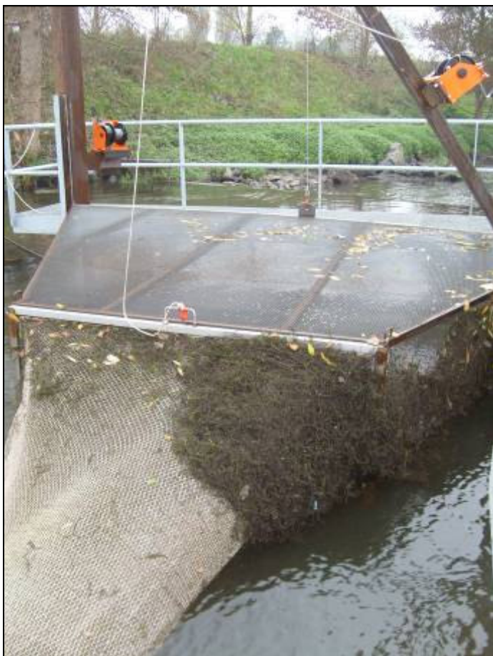
Figuur 11. Sterke vervuiling bij de bekkenvistrap (01-11-2008)
