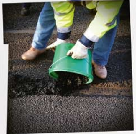
Vorstschade aan het wegdek
