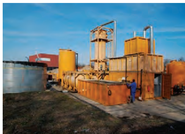
Sanering van het voormalige REGEV-gasfabriekterrein in Hilversum – zuiveringsinstallatie voor het vervuilde grondwater
