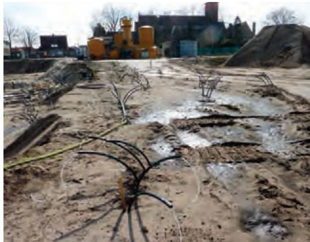
Sanering van het voormalige REGEV-gasfabriekterrein in Hilversum – leidingen voor het injecteren van Fenton's reagens
