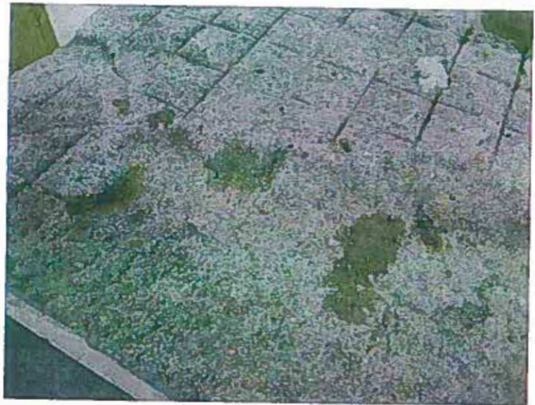
Foto 2 Vochtige plekken in de zand-cementvloer.
