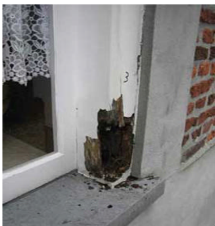
Vergunning vervangen verrot kozijnhout?
