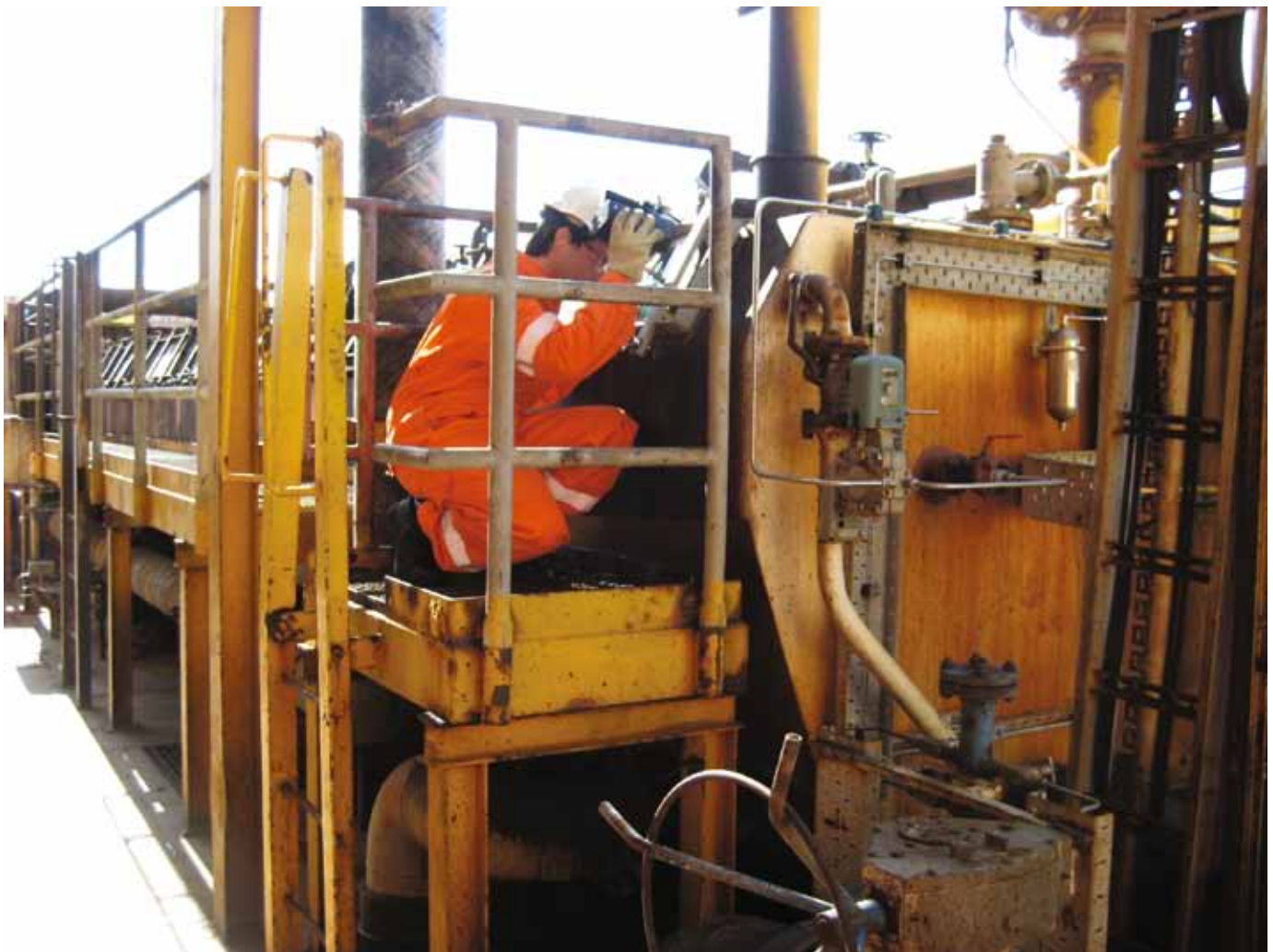
Controle van een olie/water separator tijdens een inspectie (foto SodM).
