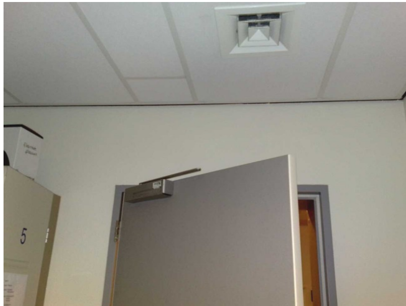
Foto 19: Losgemaakte deurdranger bij zelfsluitende, brandwerende deur.
