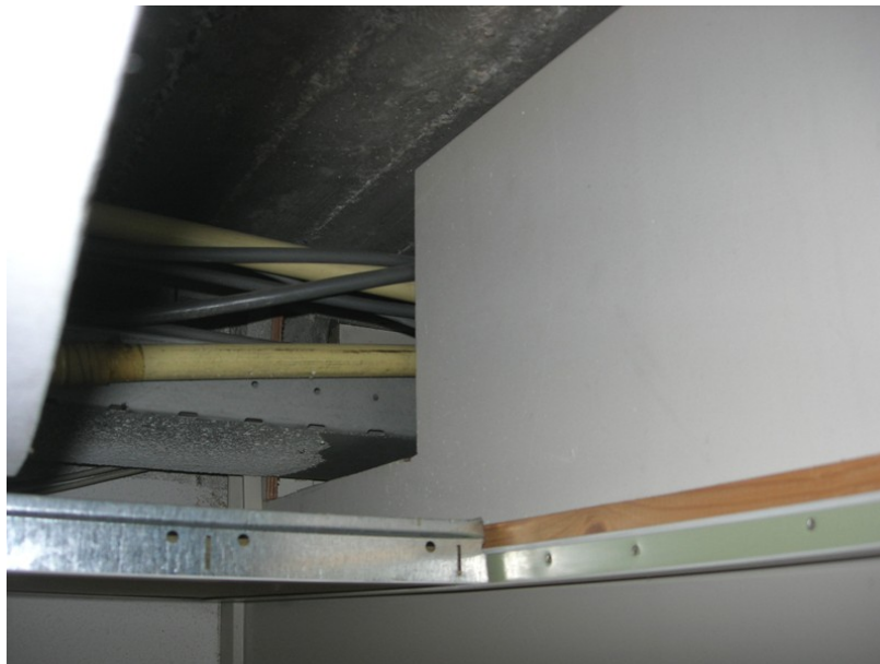
Foto 4: Niet brandwerend afgewerkte brandscheiding boven het plafond.
