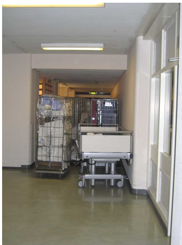
Foto 12: Obstakels in vluchtweg.
