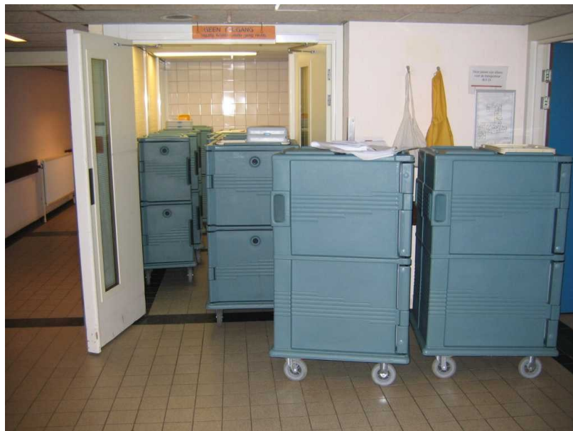
Foto 18: In geopende stand geblokkeerde, zelfsluitende deuren in brandscheiding.
