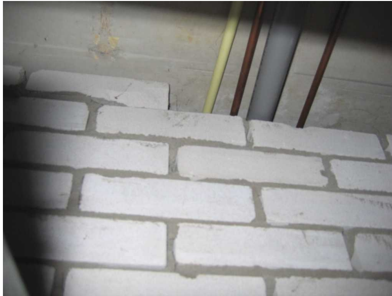
Foto 3: Niet brandwerend afgewerkte leidingdoorvoeren door brandwerende scheiding en niet op de bovenliggende vloer aansluitende scheidingswand.
