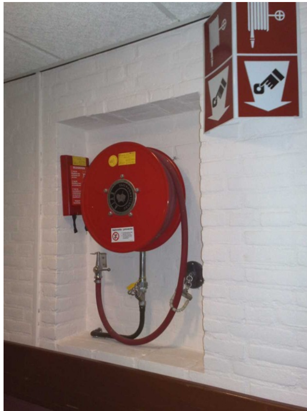
Foto 15: Goed zichtbare en bereikbare brandslanghaspel.
