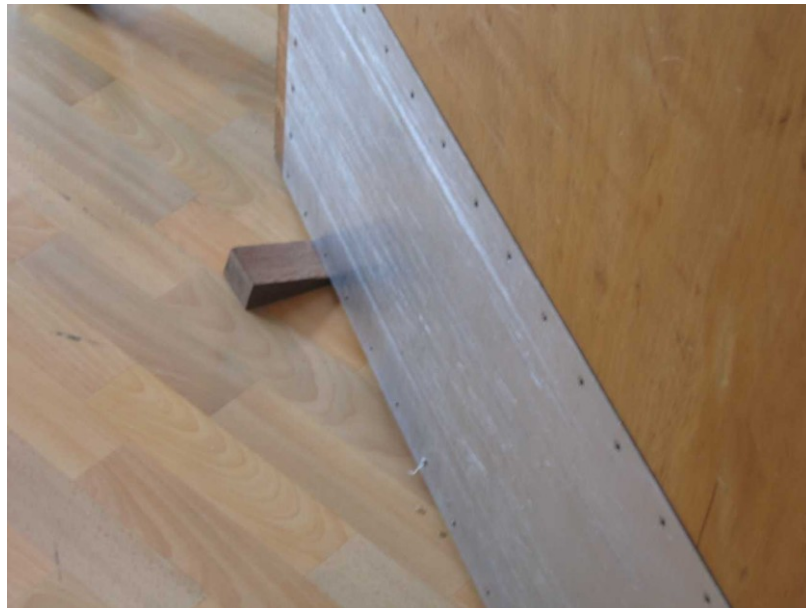
Foto 17: In geopende stand vastgezette, zelfsluitende deur in brandscheiding.
