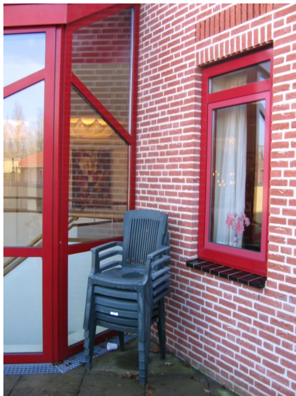
Foto 22: Ontbreken brandwerend glas tussen twee brandcompartimenten (risico brandoverslag).
