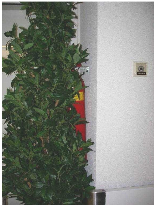
Foto 16: Niet goed zichtbare en bereikbare brandblusser.
