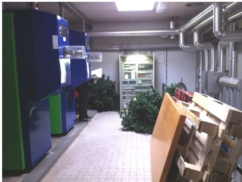
Foto 14: Opslag brandbare materialen in stookruimte.
