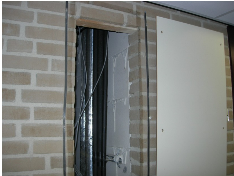
Foto 9: Niet gecompartmenteerde, verticale leidingschacht.
