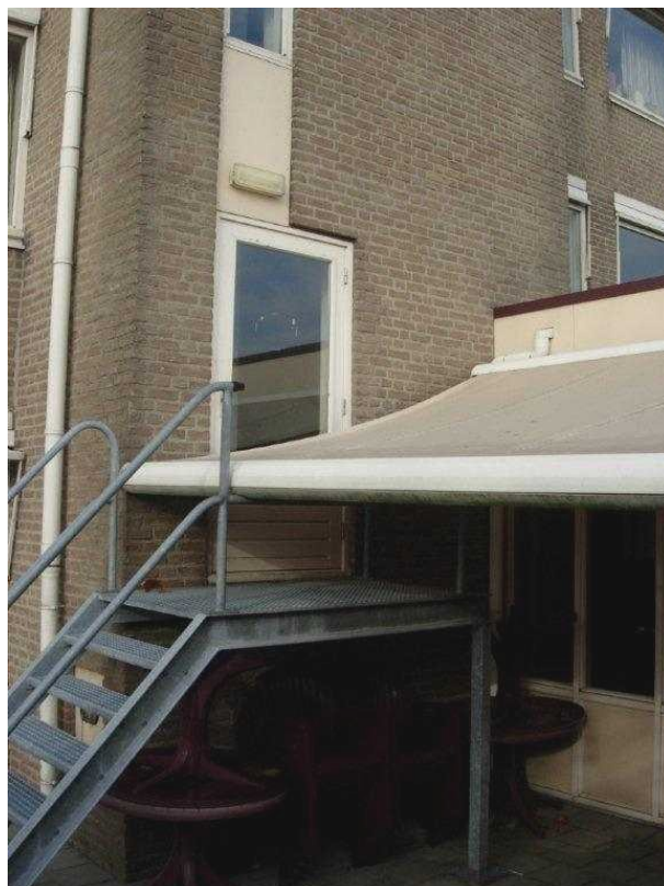
Foto 20: Geblokkeerde nooduitgang, waarop aanduiding "nooddeur vrijhouden" ontbreekt en waarbij een deel van de balustrade is verwijderd.
