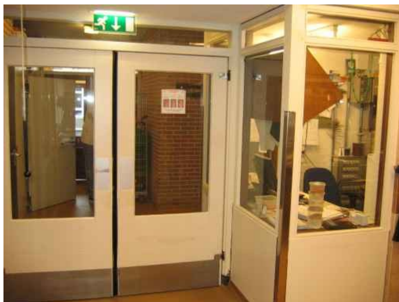
Foto 2: Te grote oppervlakte draadglas in brandwerende scheiding.
