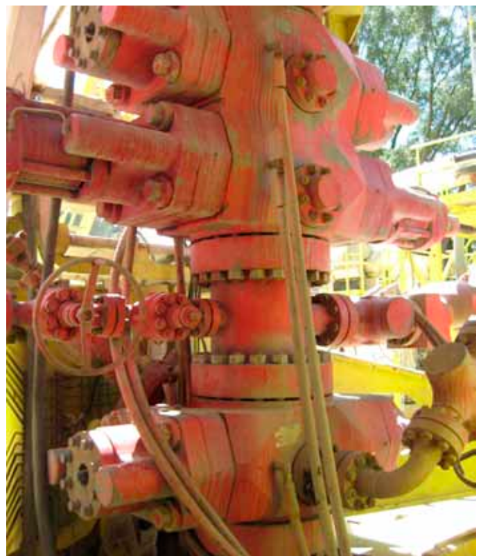
Twee aanzichten van een BOP op een mobiele boorinstallatie op een geothermieboring (foto's SodM)
