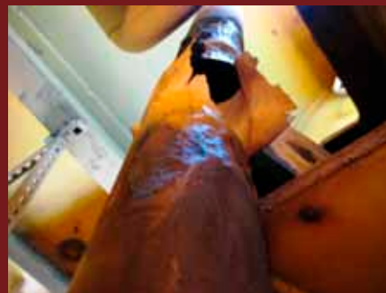
Gescheurde ventleiding door externe corrosie (foto SodM)
