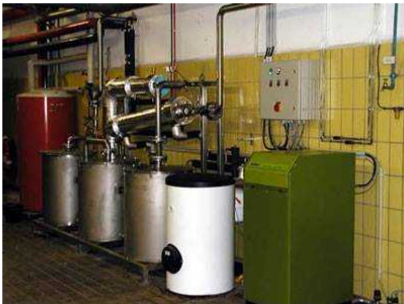
Figuur 6: Gaszuivering bij waterzuivering in Köttingen (Duitsland)
