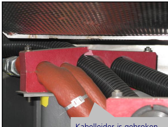
Kabelleider is gebroken
