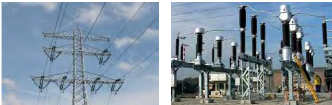
Figuur 3.26 Hoogspanningsmast en verdeelstation (voorbeelden)
