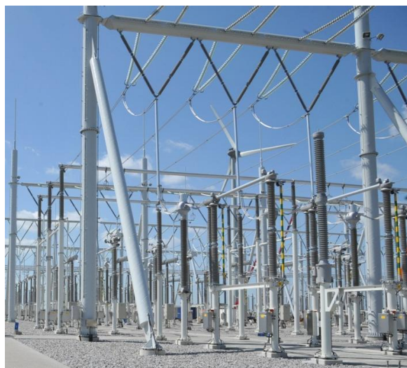
Figuur 2.2 Beeld van diverse componenten (en ondersteunende constructies) op een station
