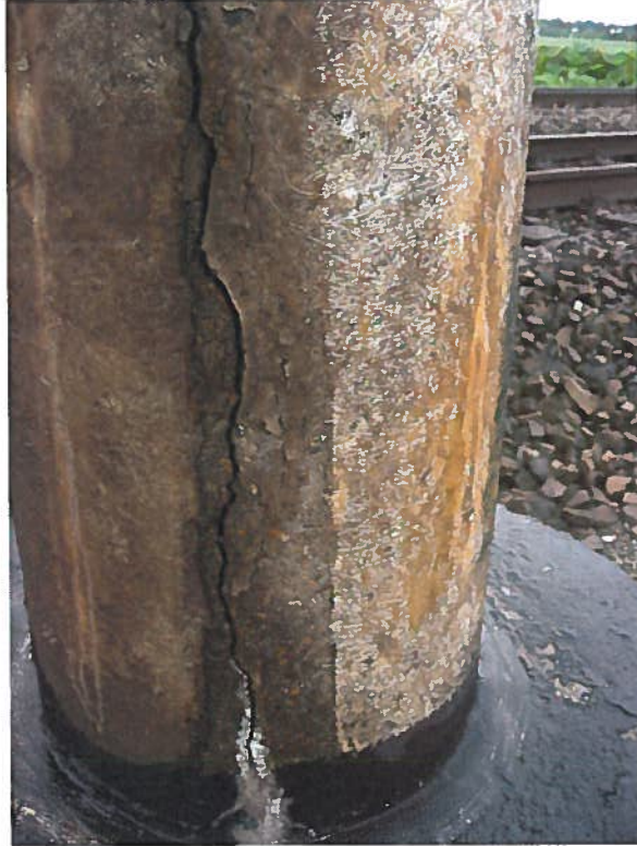
Figuur 7. Gescheurde betonnen bovenleidingsportaal, met eveneens gescheurde hars-reparatie
