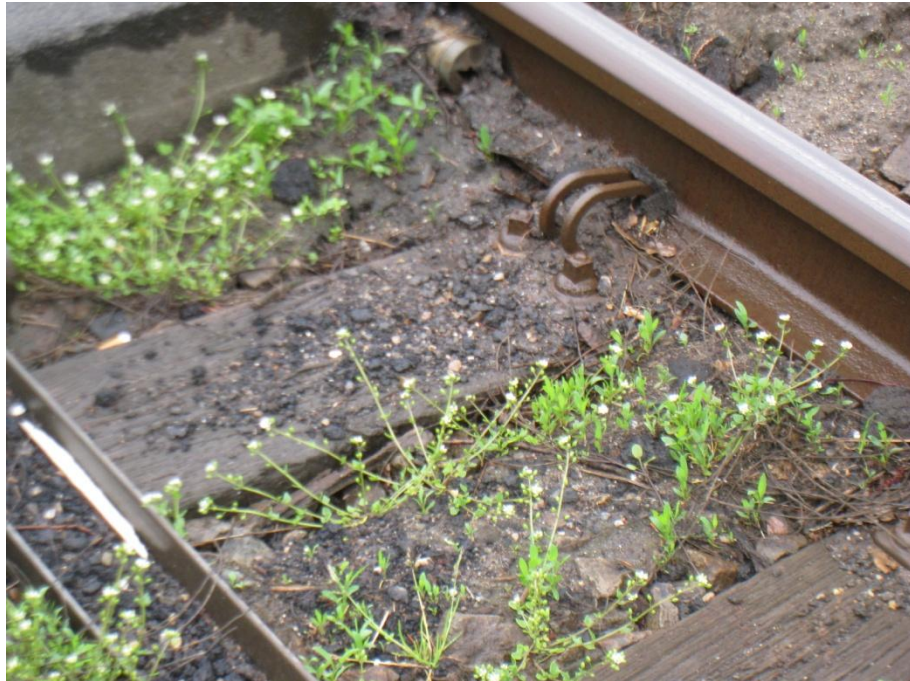
Figuur 4. Foto van klapper bij overweg in Gelre. De weggespoelde grond rondom de dwarsligger en de begroeiing is duidelijk te zien.
