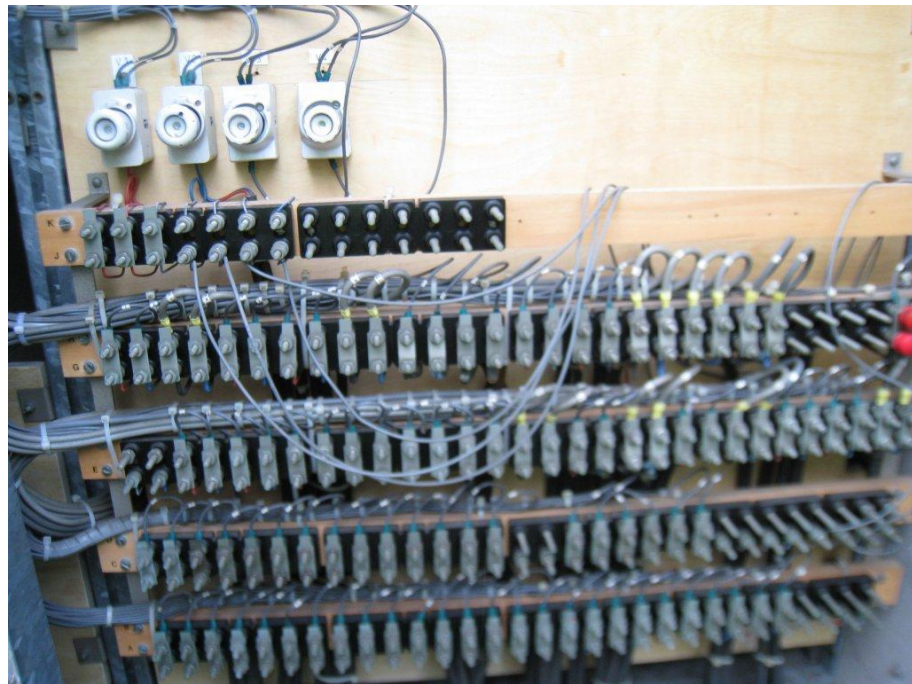
Figuur 8. Foto van slipdraden in een relaiskast. Horen niet voor te komen in een installatie en na een storing hersteld te worden.
