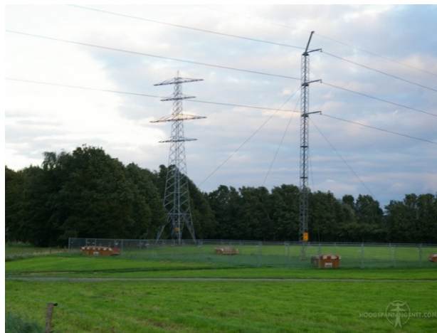
Figuur 11: Installatie van een noodmast vraagt veel ruimte, hier een noodmast 110kV-enkelcircuit.
