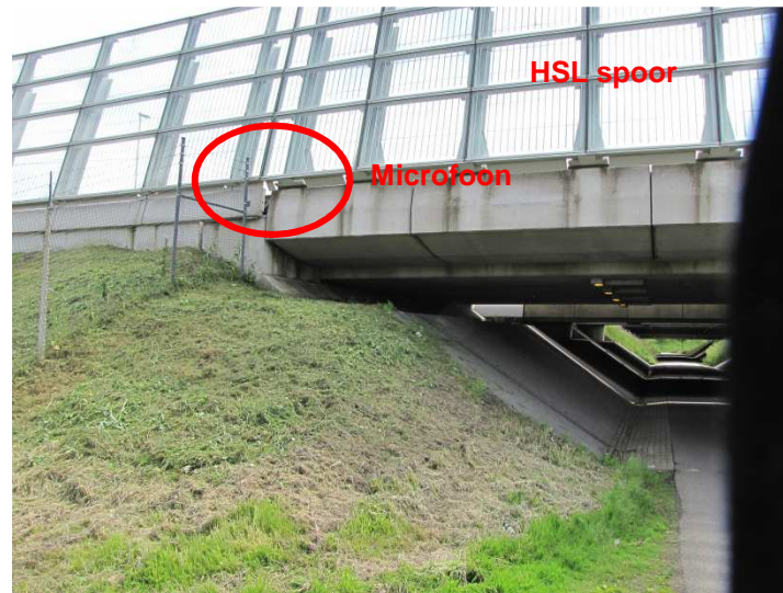
Figuur 10 Beeld van het geluidscherm en betonnen bak aan de westzijde van het HSL spoor waar de microfoon is neergelegd om de snelheid te meten.
