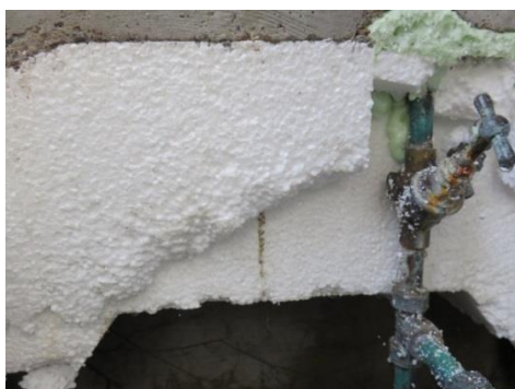
Figuur 13: Vloerisolatie woning 30
