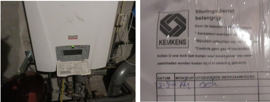
Figuur 55: CV-ketel met onderhoudssticker woning 166
