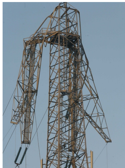
Figuur 8: Beschadiging van dubbelcircuit mast door helikopter.
