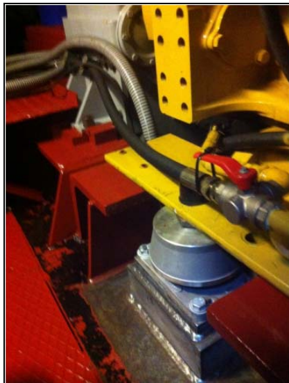
Figuur 4.4.5: motor Melvin opgesteld op trillingsisolatoren
