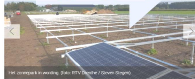
Het zonnepark in wording. (foto: RTV Drenthe / Steven Stegen)
