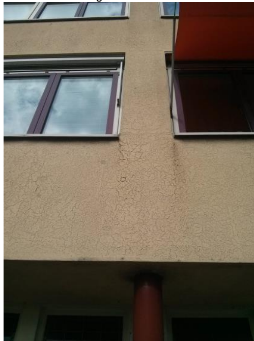
Foto 11 Zichtbaar is schade (scheurvorming) bij en poreusheid in oppervlak
