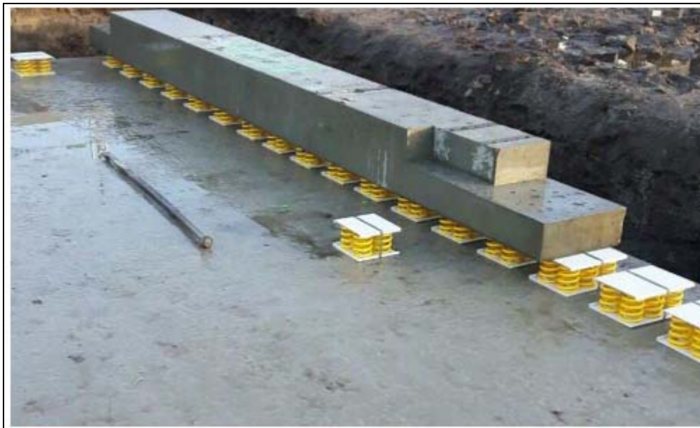
Figuur 4.1: Voorbeeld van woning op trillingsisolatoren. De gele veren zijn de trillingsisolatoren. De woning wordt op de betonnen stroken gebouwd. Foto overgenomen uit Nieuwsbrief "Lavas" van Van Grunsven Projectontwikkeling januari 2017
