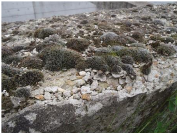
Figuur 5.9: Plaatselijke schade aan het betonoppervlak van een wandje (foto B.12 in [02])
