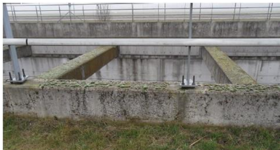
Figuur 5.8: Mosgroei op wandje op gording; geen mosgroei rondom staanders van hekwerk (foto B.7 in [02]).
