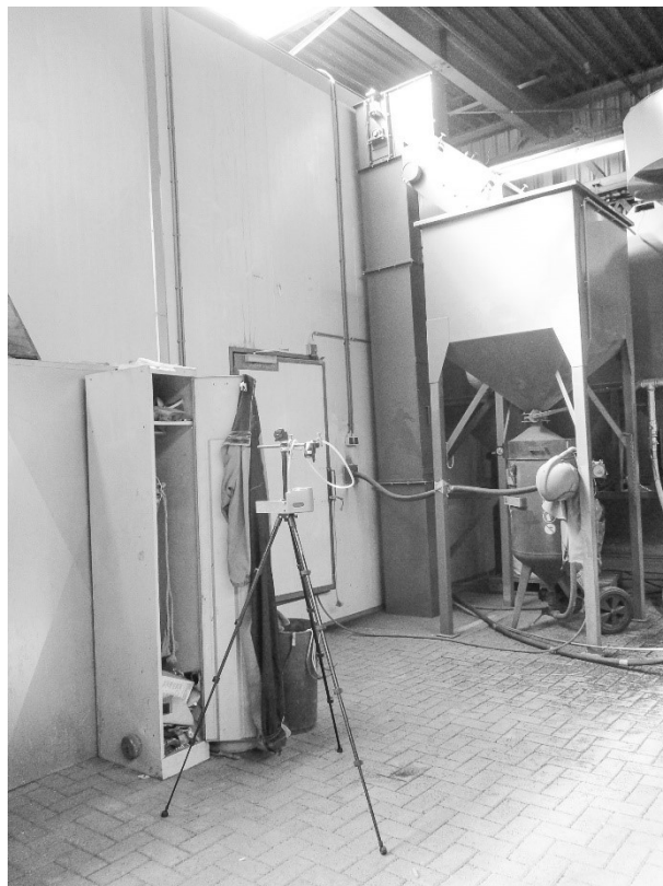
Meetlocatie 3: Positie stationair meetpunt bij ingang straalcabine, rechts straalketel met daarboven een vulsilo
