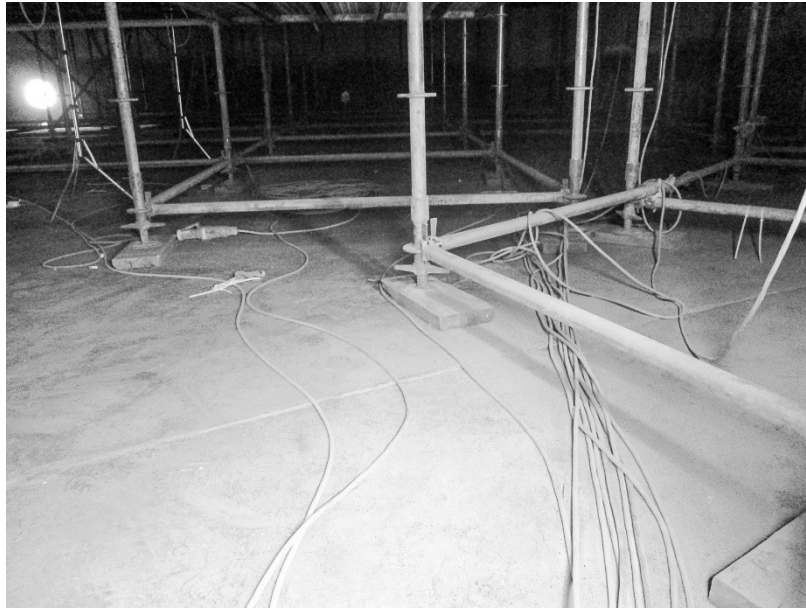
Meetlocatie 1C: Verontreiniging op de vloer van de tank nadat deel van de steiger is afgebroken
