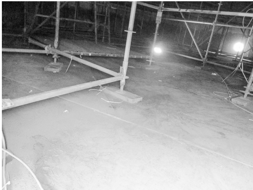
Meetlocatie 1C: Verontreiniging op de vloer van de tank nadat deel van de steiger is afgebroken, inclusief positie stationair meetpunt in de tank tijdens werkzaamheden
