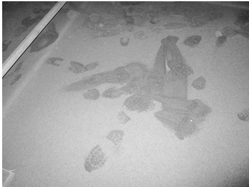
Meetlocatie 1C: Aanwezigheid verontreinigd straalgrit op de vloer van de tank (doorheen gelopen tijdens activiteit 'verplaatsen/inspectie')
