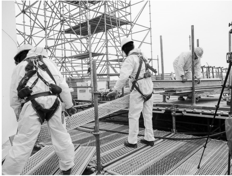
Meetlocatie 1C: Aannemen en opstapelen steigermateriaal, inclusief positie stationair meetpunt (vlakbij mangat)
