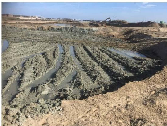
Figuur 4.4 Staand water op Noordse Leem in een terreinophoging: een omstandigheid die bij het verwerken van Noordse Leem te allen tijde vermeden moet worden, omdat de sterkte en samendrukbaarheid van Noordse Leem door een te hoog watergehalte verslechteren
