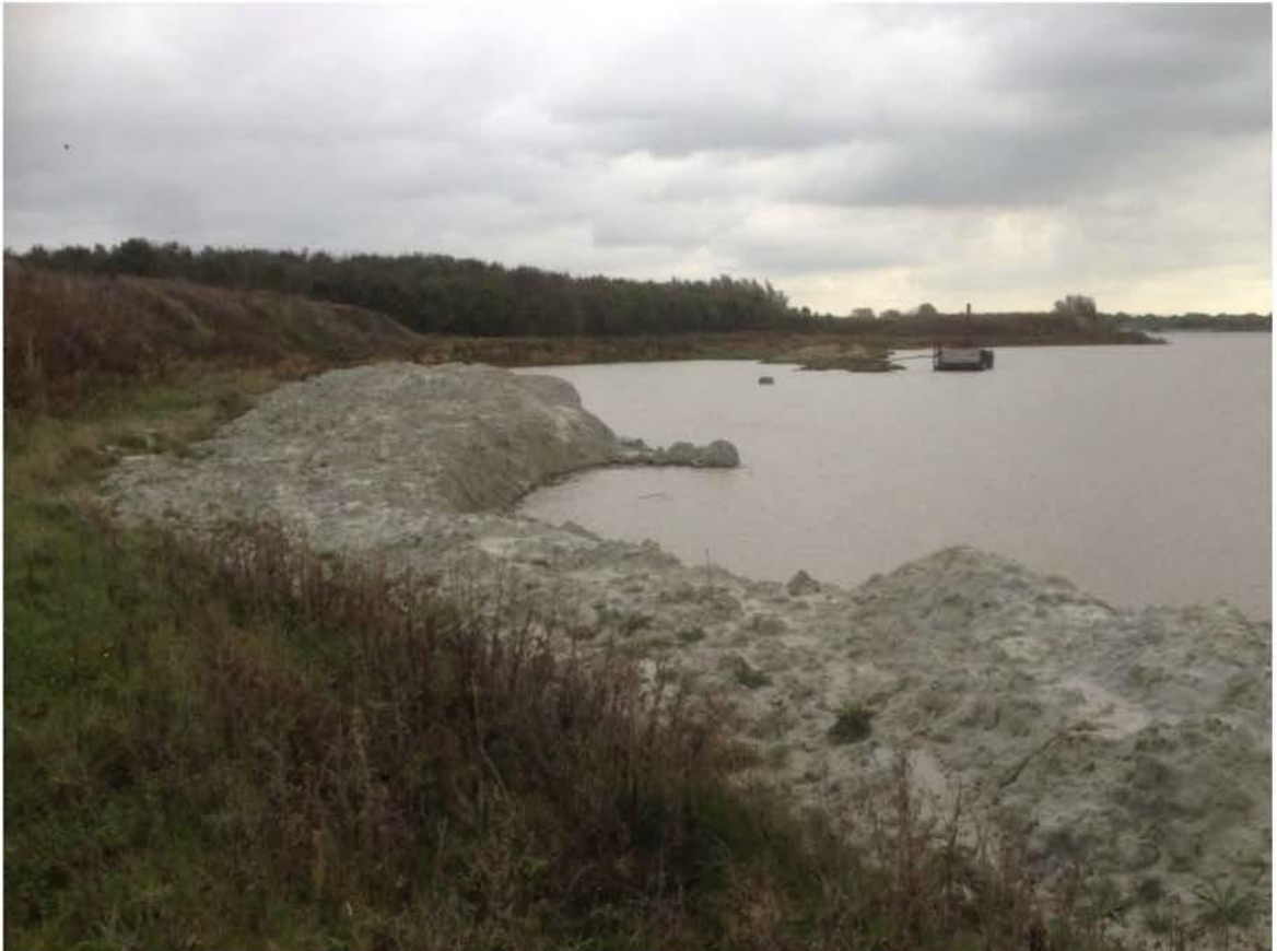
Figuur 2.4 Noordse Leem gebruikt voor afdichting van een zandwinput (Cuijk) – tijdens de aanleg
