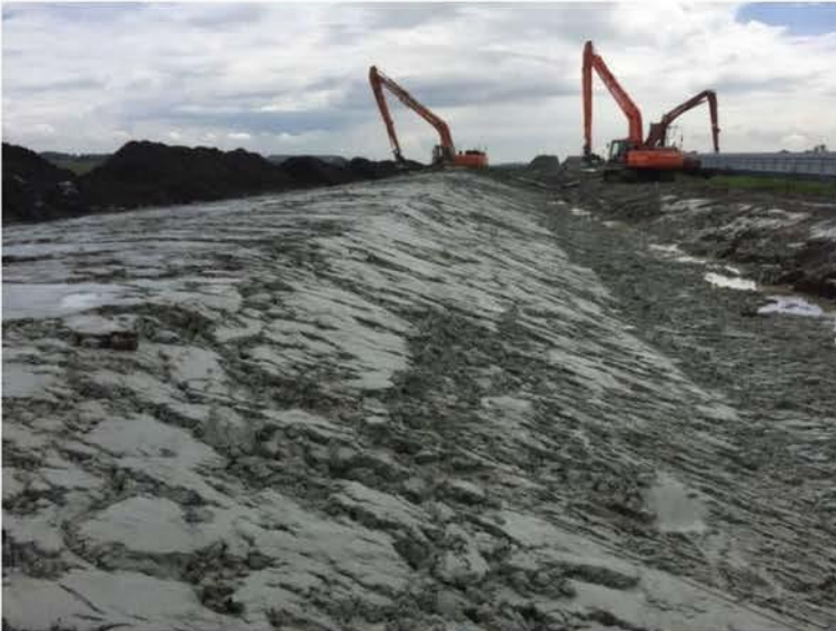
Figuur 2.2 Noordse Leem in een boezemkade (Hooivaart, Akkrum). Op de achtergrond de grond die voor het afdekken van de Noordse Leem wordt gebruikt
