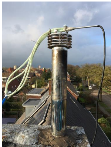
Figuur 15 : Foto van de op maat gemaakte schoorsteenkap. De aanvoerleiding (links op de foto) voert stikstof aan ter verdunning van het rookgas, dat in de kap wordt aangezogen. De anti-statische leiding naar de meetwagen is rechts op de foto zichtbaar.
