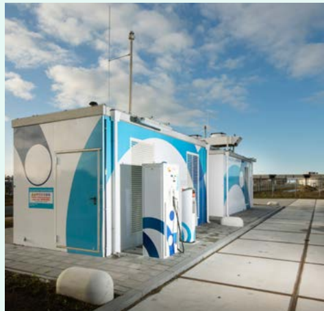
Waterstof-tankstation voor openbaar vervoer, Delfzijl.
