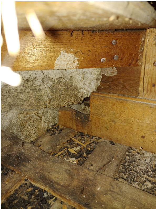
Figuur 3.9: Oude plafonds zijn aantrekkelijk voor ratten en muizen (bron: Alex Mars, Mega-Des).
