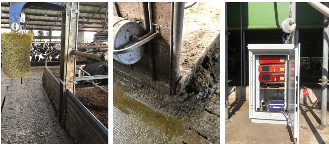
Afbeelding 2.1 De linker en de middelste foto laten een voorbeeld zien hoe de meetleidingen onder de vloer gaan. De rechtse foto laat een voorbeeld van de apparatuur zien, die buiten in een geïsoleerde kast staat.
