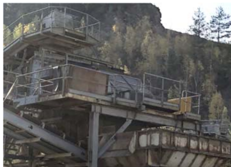
Yvoir: 1 wasser, nadere inspectie niet mogelijk
