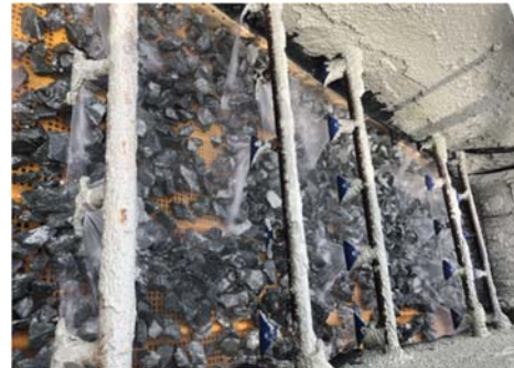
Amsterdam (Bremanger/Glensanda): 1 wasser met 5 buizen x 5 sproeiers
