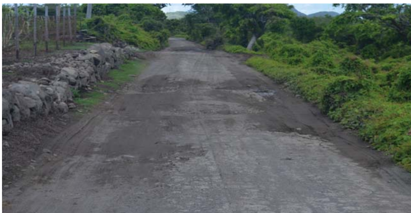
De staat van onderhoud (september jl.) van de Road Behind the Mountain.
