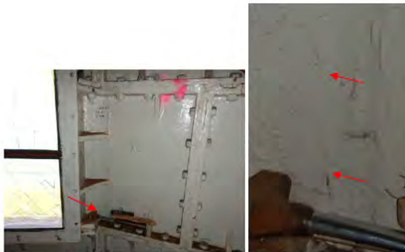
Figuur D 12 Foto's van scheuren met waarschijnlijk conservering over de scheur (foto's 8467 (2x) 7131 (2x) 4191, 4190, 8796 (2x), 7081 (2x) uit [4]).
