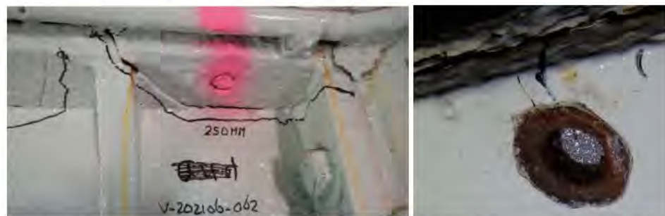
Figuur D 14 Foto's van de scheuren met schade aan de conservering (links, foto 6855 uit [4]) en zonder schade aan de conservering (rechts, foto 4149 uit [4]).
