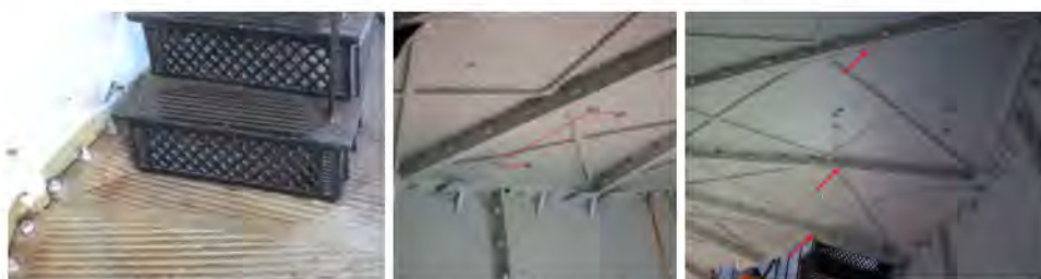
Figuur D 5 Voorbeelden van scheuren dwars door de vloerpanelen (foto's uit [8]).
