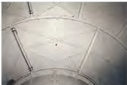
Figuur D 6 Voorbeeld van een scheur dwars door een vloerpaneel die niet is ontstaan vanuit een trapgat (foto uit [17]).
