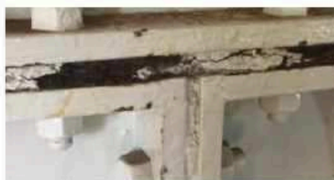
Foto 4, aantasting van ijzercementvoegen
