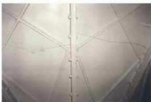
Foto 3, scheurvorming vloer (v.a. onderzijde)
