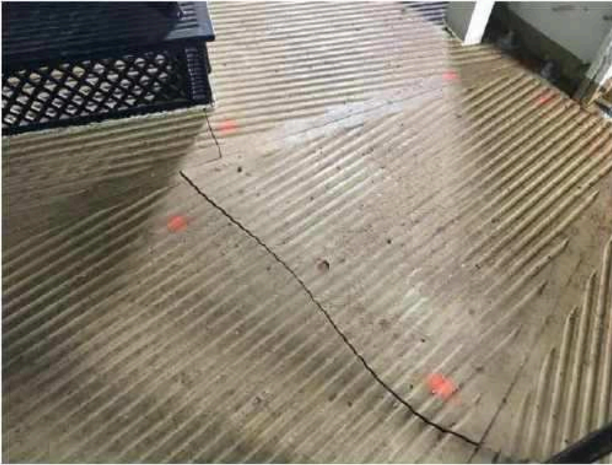
Figuur 2: scheur door vloerplaat heen
