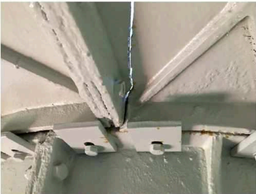
Figuur 3: scheurvorming bij "opleghandje" vloerplaat
