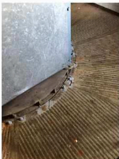
Foto 5: Vloer los van de binnenschacht
