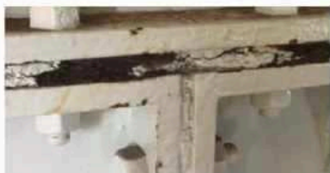
Foto 4, aantasting van ijzercementvoegen
