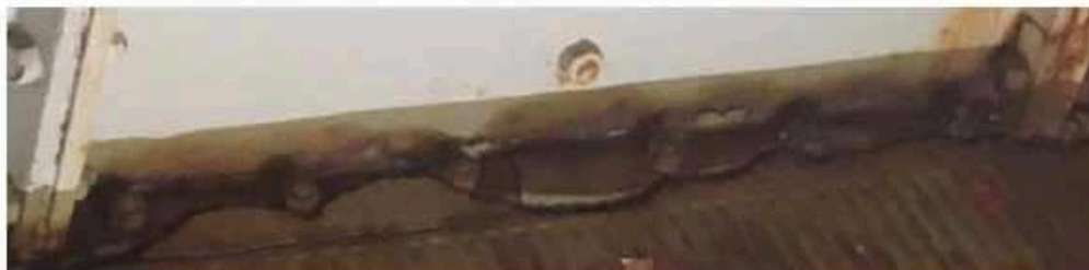
Foto 1, scheurvorming vloer nabij buitenwand
