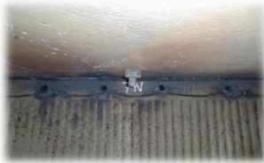
Plaat 7N, bouten verwijderd
