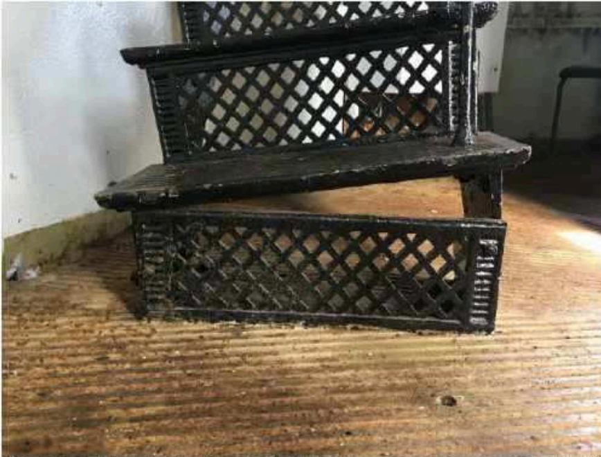
Figuur 4: onderste stootbord losgescheurd van trap, verzakking van vloer duidelijk te zien
