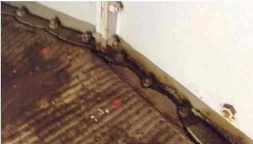
Figuur 7: scheurvorming langs vloerrand bij buitenschacht
