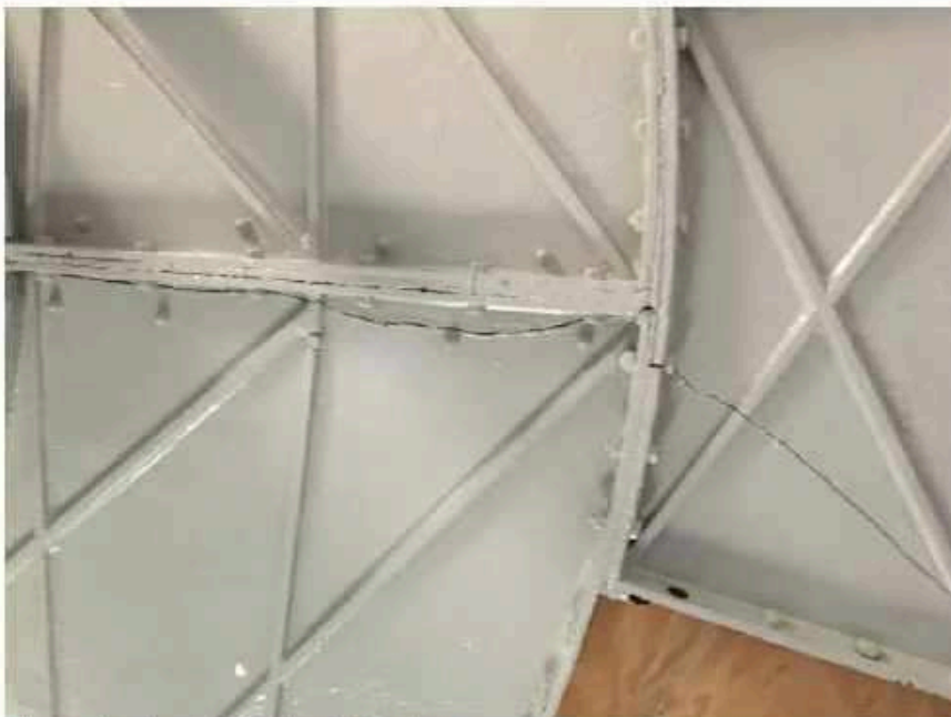
Figuur 1: scheur door vloerplaten heen
