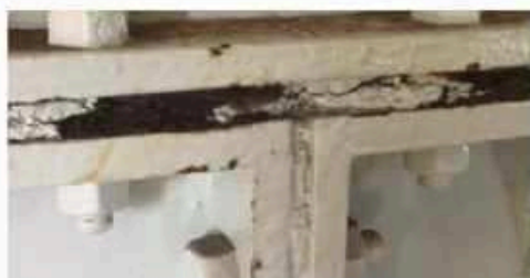
Foto 4, aantasting van ijzercementvoegen
