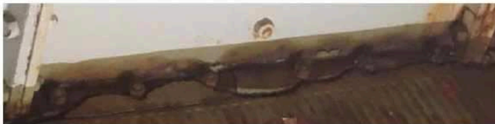
Foto 1, scheurvorming vloer nabij buitenwand
