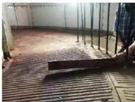
Foto 6: Zichtbaar scheve vloer
