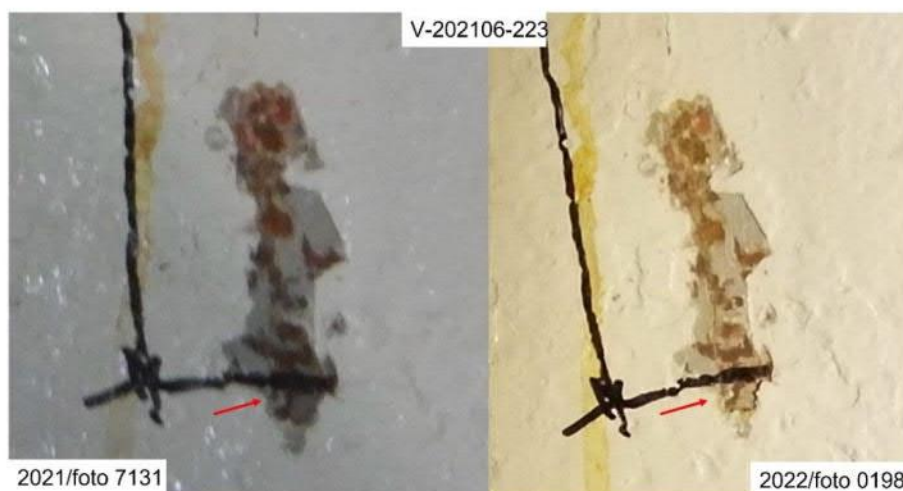
Figuur 2.1: Schade V-202106-223; foto van nulopname (links) en van drone-inspectie (rechts)
