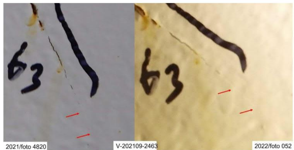
Figuur 2.4: Schade V-202109-2463; foto van nulopname (links) en van drone-inspectie (rechts)
