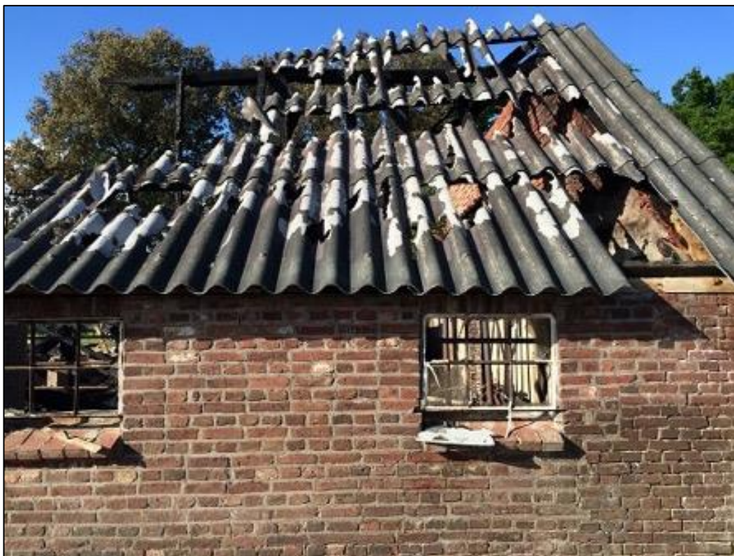
Foto: Asbestdak na een brand. Asbestdelen zijn verspreid in de omgeving
