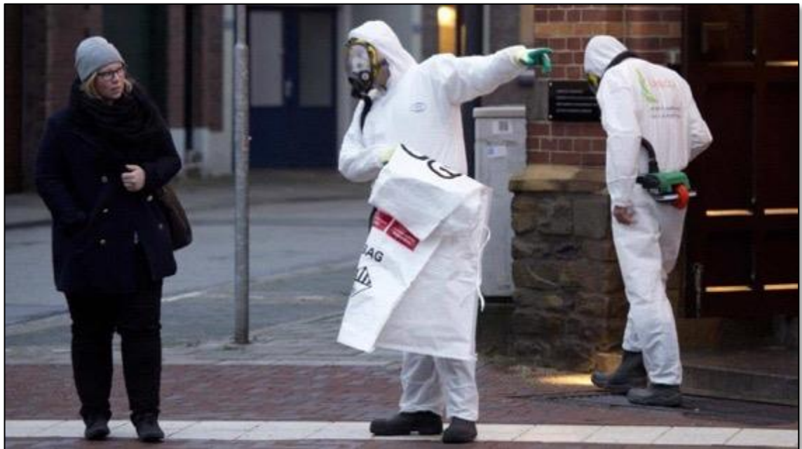
Foto: Tijdens het opruimen van asbestdeeltjes in het centrum van Roermond na de asbestbrand van 16 december 2014
