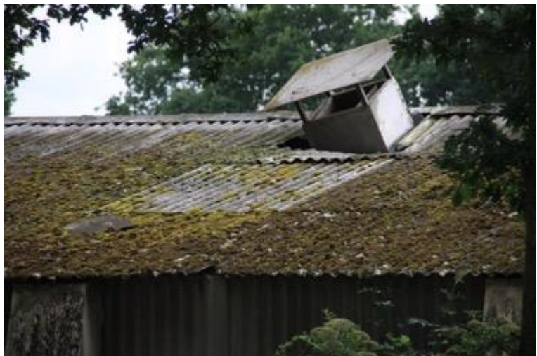
Foto: Bouwvallig pand met een asbestdak
