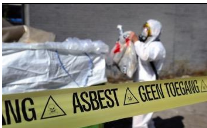
Foto: Afvoeren van asbestafval na een brand
