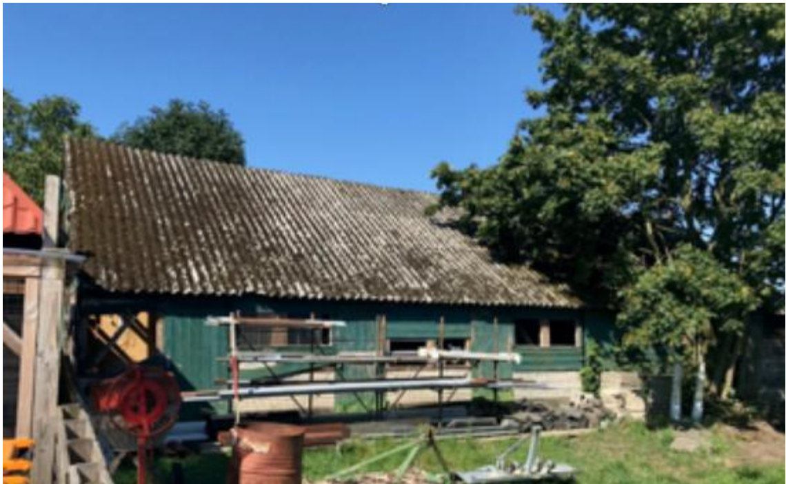
Foto: Schuur met asbestdak, zonder dakgoot. Asbestvezels komen op het maaiveld terecht in de druppelzone (op de grond) ©Geofoxx
