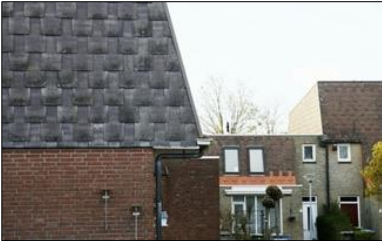
Foto: asbesthoudende leien in Lelystad
