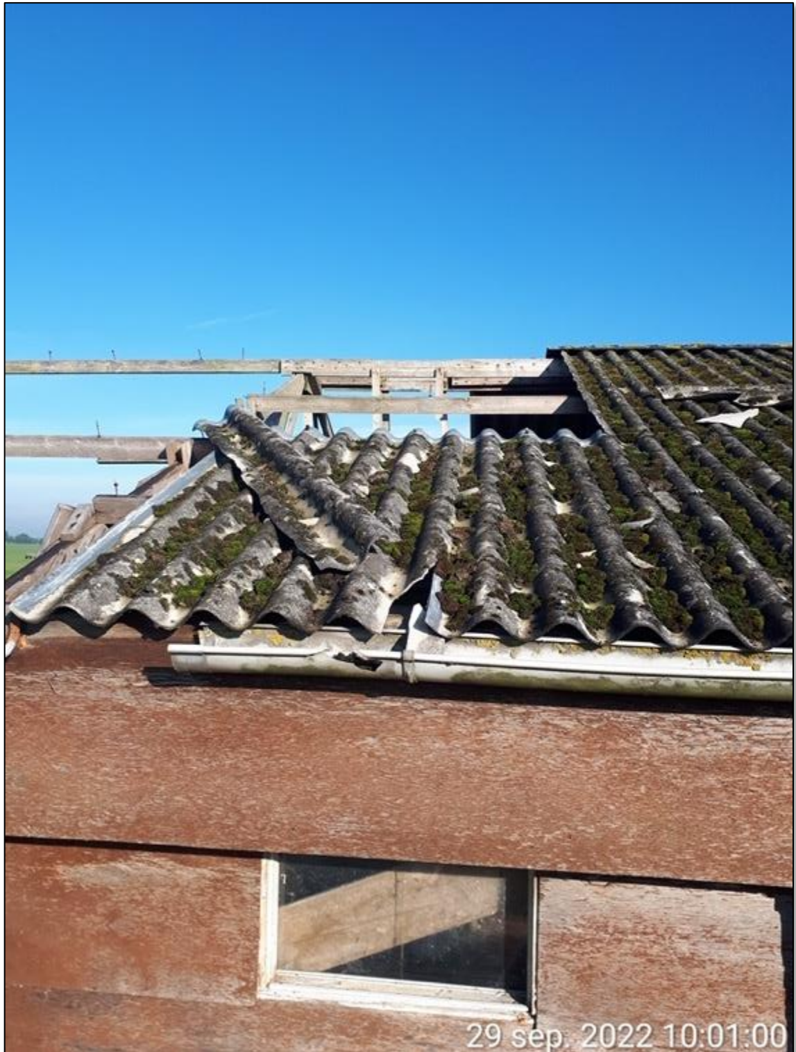
Foto: Beschadigd dak. Wind kan hier vat op krijgen en zorgen voor verdere beschadiging © Omgevingsdienst Regio Utrecht
