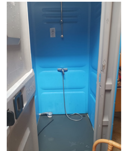
Afbeelding 8. Nooddouche in cno Hendrik Ido Ambacht in gymzaal (14 juni 2023)
