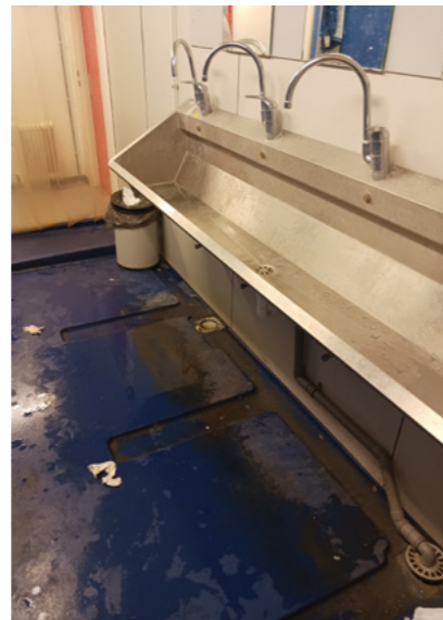
Afbeelding 10. Wastafels in no Assen (14 juni 2023)
