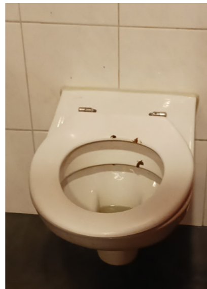
Afbeelding 9. Vies sanitair in no Assen in evenementenhal (14 juni 2023)
