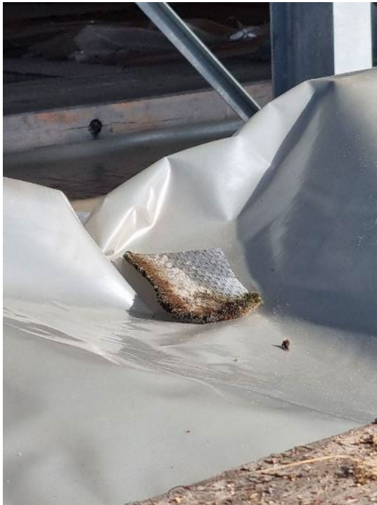
Foto 11: Stukje afgebroken golfplaat
