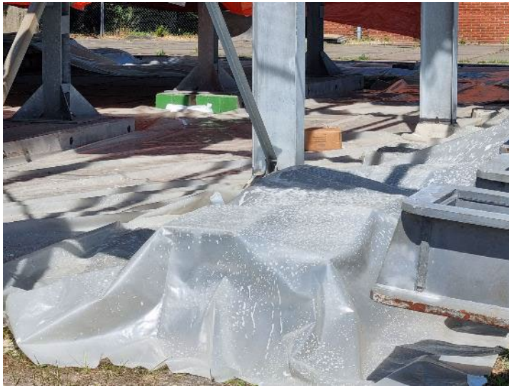
Foto 37: Zeil op objecten in/naast de deurenloods onder asbestdak, schuim valt op het zeil tijdens inschuimen dakspanten
