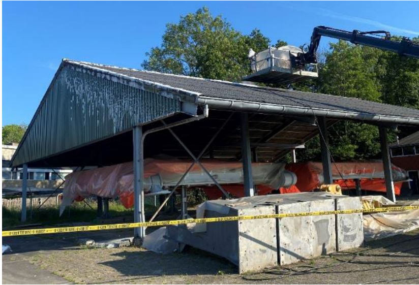
Foto 7: Asbestcement nokstukken aan de zijkant en bovenkant zijn grotendeels ingeschuimd. Het aangebrachte schuim is deels weer verdwenen.
