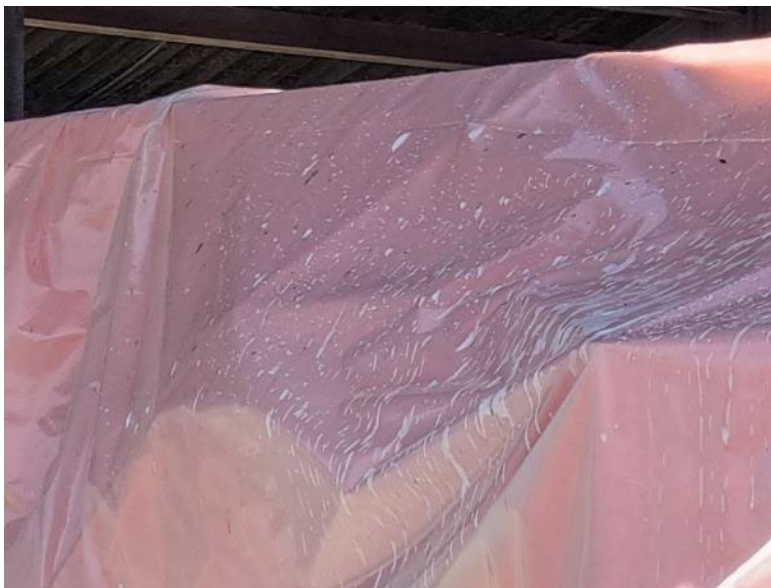
Foto 36: Zeil op objecten in de deurenloods onder asbestdak, schuim valt op het zeil tijdens inschuimen dakspanten (zie vorige foto's)
