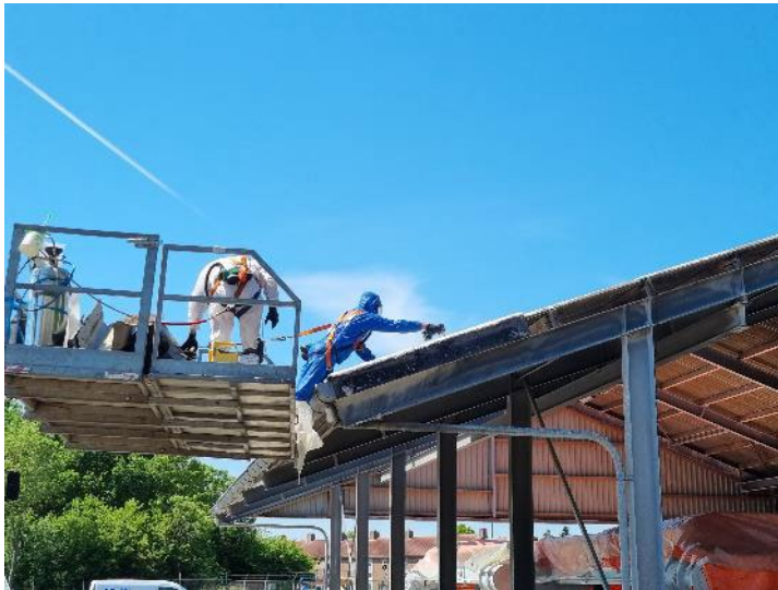
Foto 29: Losschroeven dakbouten de uit de asbestcement golfplaat (nokstuk zijkant)
