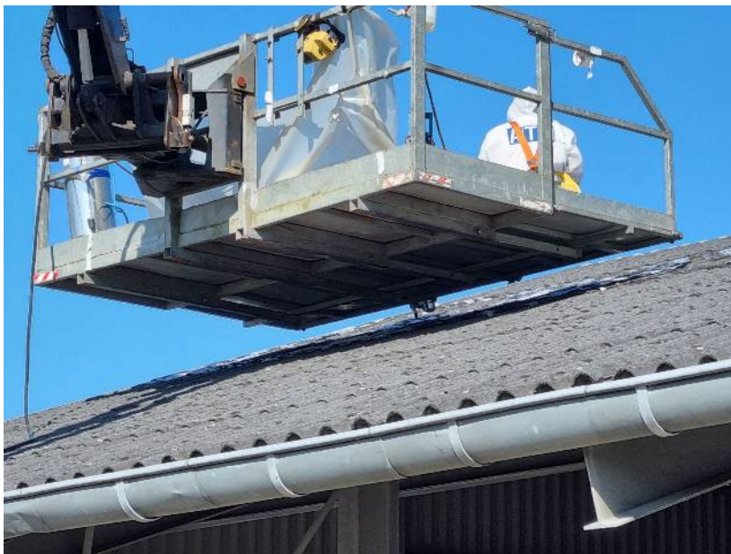
Foto 13: Losschroeven asbestcement golfplaat
