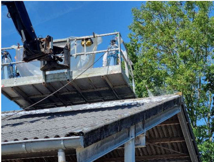
Foto 25: Inschrijven volgende deel asbestdak
