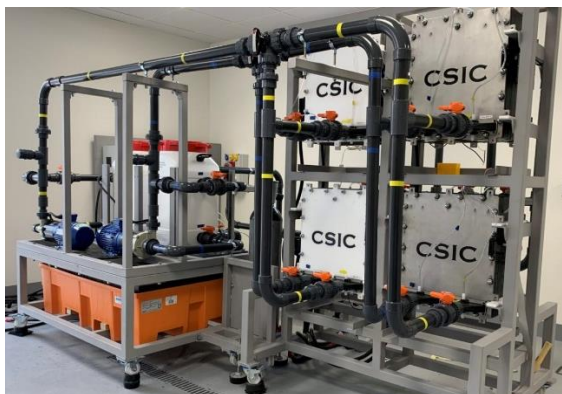
Figuur 5. Vanadium flow batterij demonstratie opstelling 20 kWh
