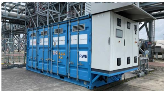
Figuur 6. Battolyser pilot op RWE in Eemshaven
