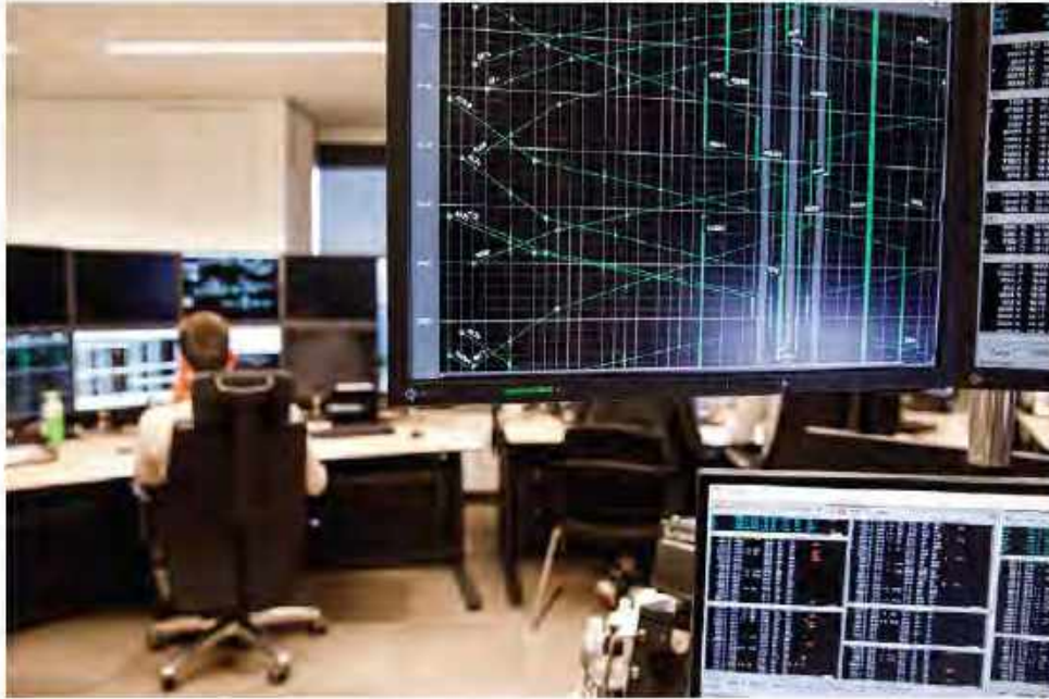
Opleidingsruimte voor treinverkeersleiders in het OCCR, Utrecht.
