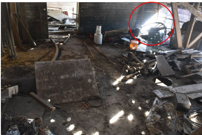
Afbeelding 7: Bergruimte boven de technische ruimte. Brandschade met rode cirkel aangegeven.
