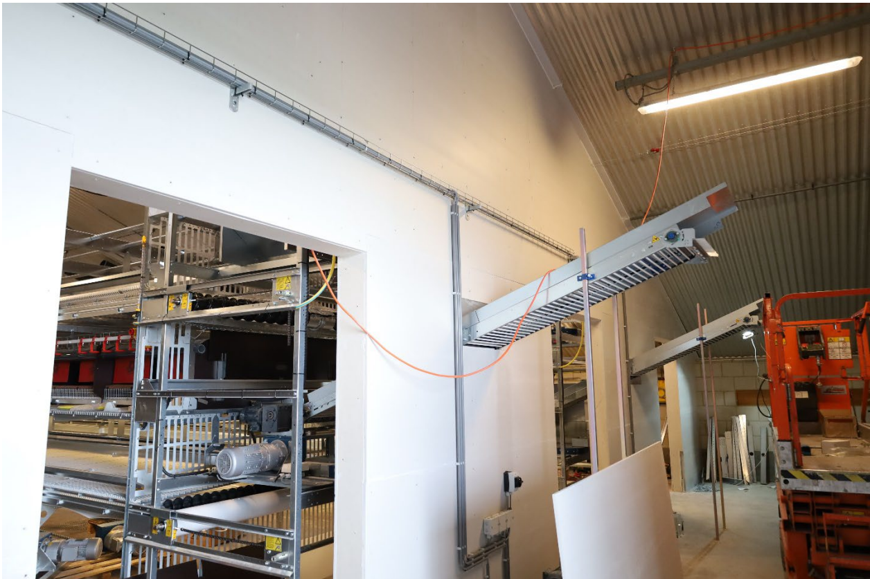
Figuur 3.3 Voorbeeld van een eierverzamelband direct van de dierruimte naar de ruimte met eierverzamelapparatuur in een stal in aanbouw. (Bron: Geissler Installatietechniek)
