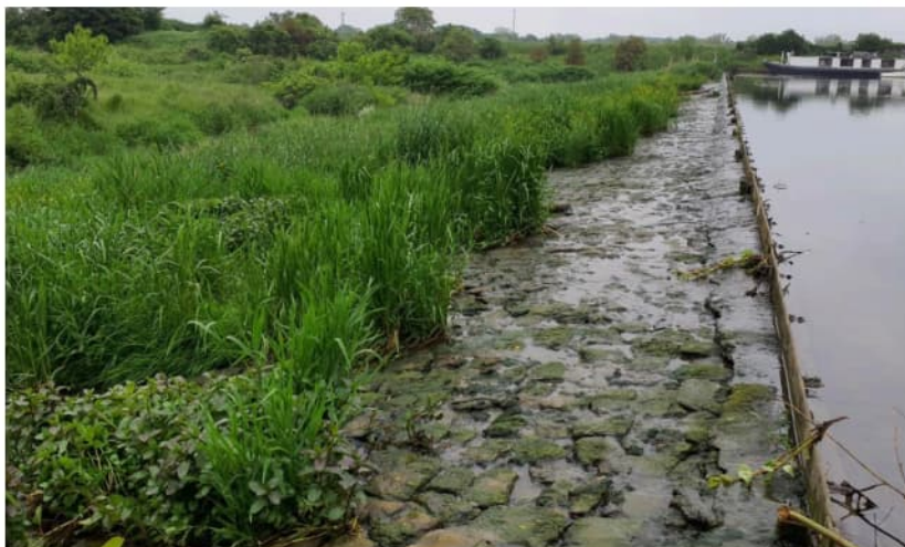
Figuur 2.10 De bekleding lijkt deels niet goed zichtbaar door de dichte begroeiing (linkerzijde van de foto), bron: inspectierapport 2023.
