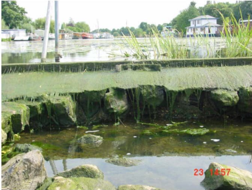
Figuur 4.14 Schade aan steenzetting in juli 2003 (bron: Rijkswaterstaat-Zuid Nederland (2024a) )
