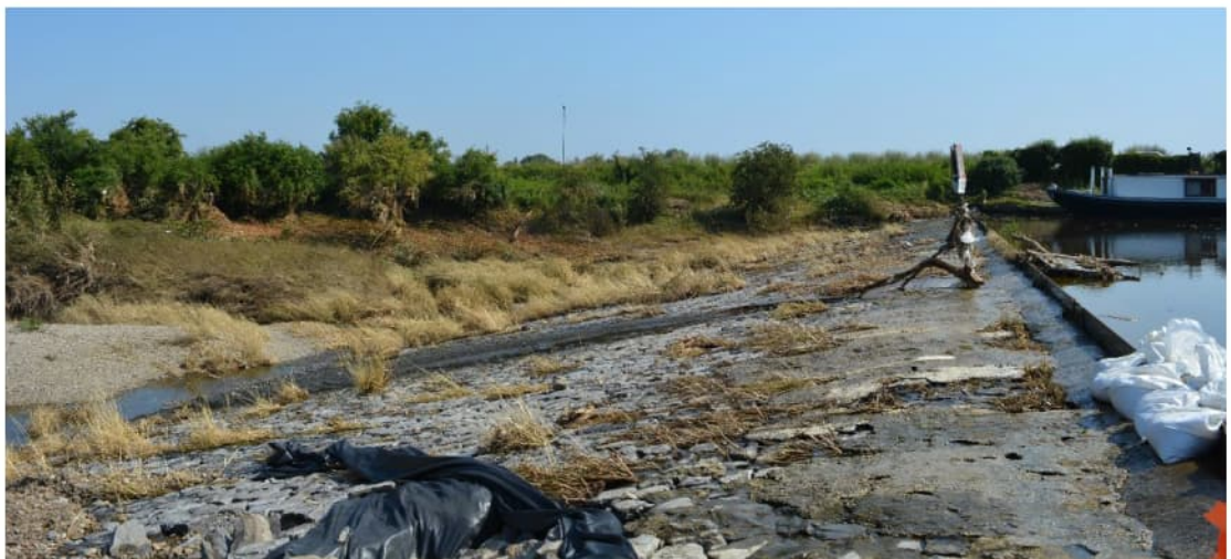
Figuur 4.3 Foto na aanleiding van de schade in juli 2021, overlaging met beton zichtbaar op kruin, mogelijk aangebracht in 2014, foto Deltares
