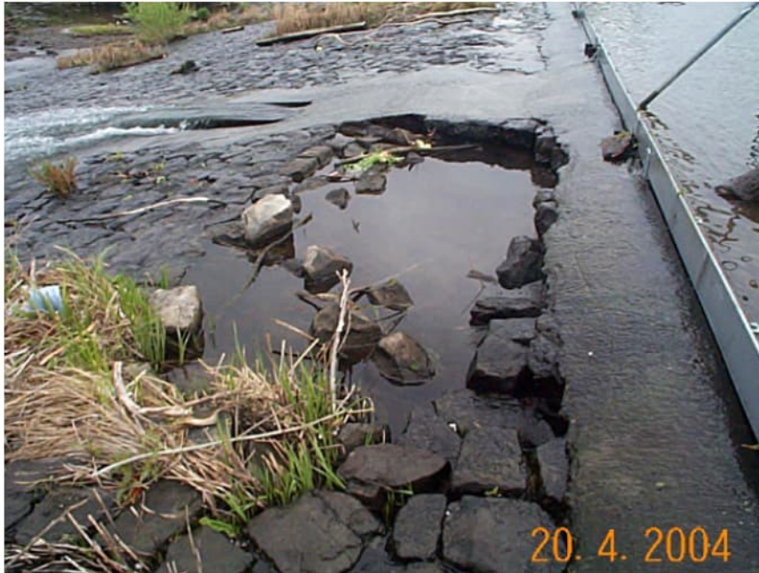
Figuur 4.16 Schade aan steenzetting in april 2004 (bron: Rijkswaterstaat-Zuid Nederland (2024a) )
