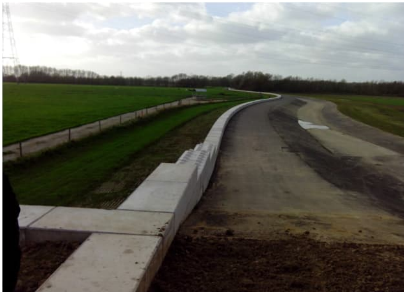
Figuur 6.11 Foto van inlaatlocatie/instream/overlaat drempel LKW-Zuid (de instroming is van links naar rechts). Datum onbekend.
