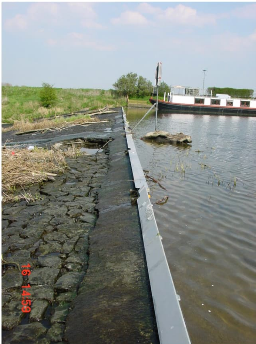
Figuur 4.17 Schade aan steenzetting in april 2004 (bron: Rijkswaterstaat-Zuid Nederland (2024a) )
