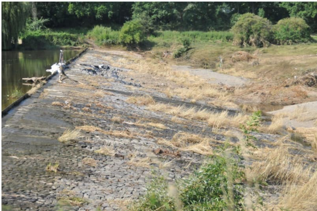
Figuur 4.5 Zijaanzicht van de overlaat met de schade.
