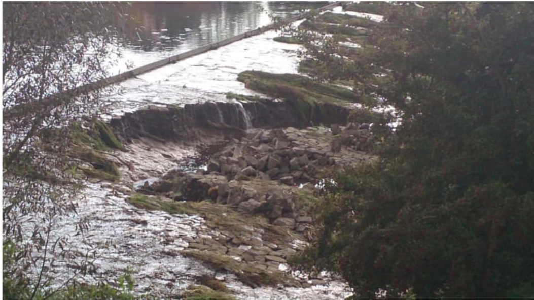
Figuur 4.2 Schade aan de overlaat, september 2014, bron RWS.
