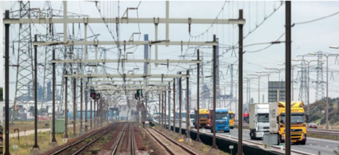
modernisering van de treinbeveiliging voor de Havenspoorlijn
