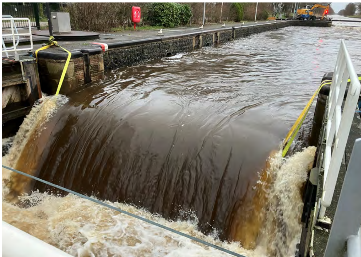
Vanwege een storing aan het spuiwerk werd Schutsluis IV bij Haghorst sinds november 2023 enkele maanden ingezet om het peil in het Wilhelminakanaal te reguleren. De scheepvaart werd daarbij gestremd.
