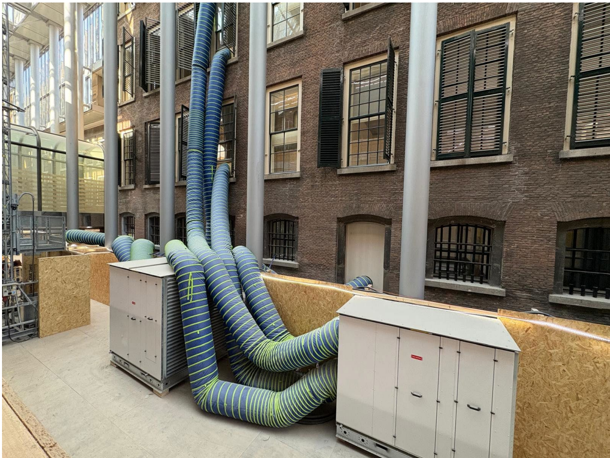
Tijdelijke klimaat installaties Tweede Kamer
